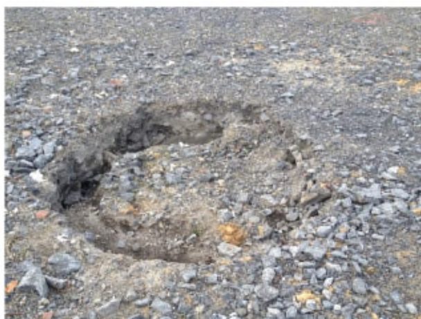
Tassement de remblai ou début d'effondrement
